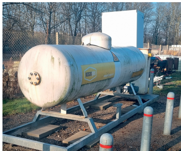
Tankgastankanlæg på Hammershusvej 7. Foto: Herning Kommune
